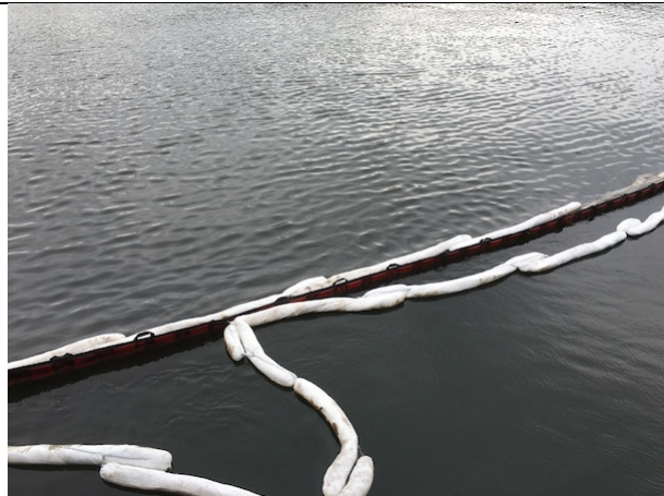
Foto 2. Particolare del barrieramento con panne rigide e barriere oleoassorbenti durante la manutenzione ordinaria
